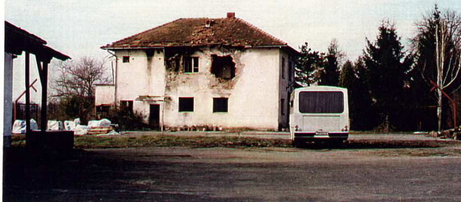
Ostaci porušene građevine u Lasinji
